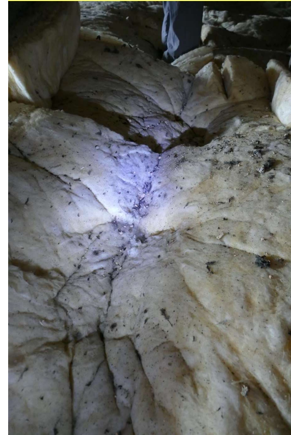
Figure 18. Guano sur laine de verre observé dans un grenier – projet de parc éolien des Rainettes – Chantraines (52).
