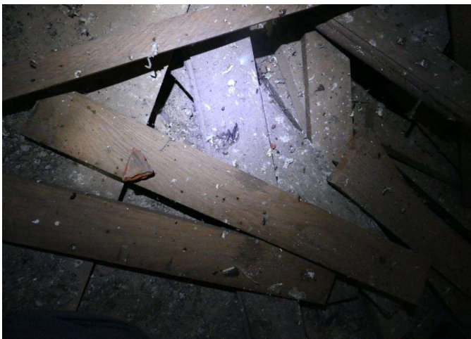
Figure 19. Guano retrouvé dans une grange – projet de parc éolien des Rainettes – Chantraines (52).
